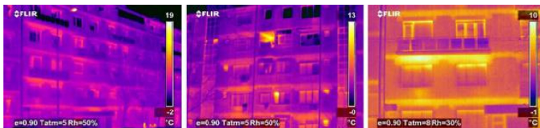
Slika 208. Termovizijski snimci ulične i dvorišne fasade sa jasno vidljivim toplotnim gubicima (Stevanović Z., i dr., 2009)
