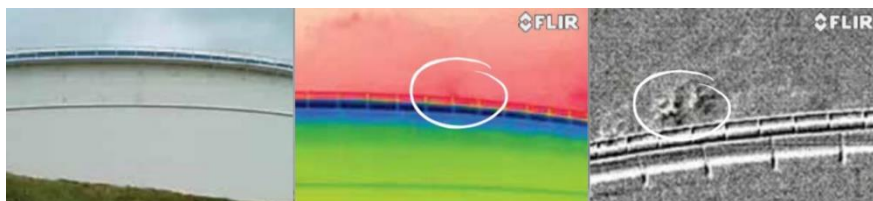
Slika 13. Curenje gasa iz rezervoara (vidljiva slika, termogram i termogram - High Sensitivity Mode) [24]
