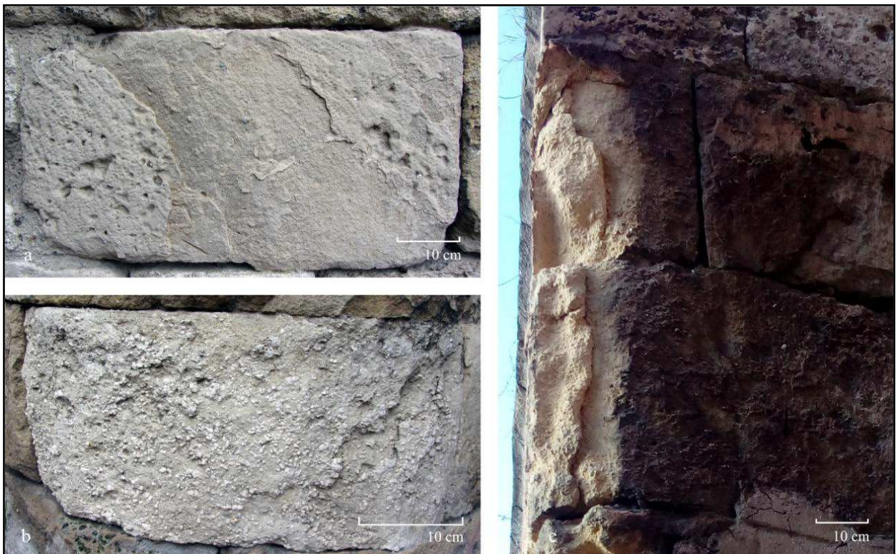
Sl. 63. Degradacija blokova krečnjaka u formi odvajanja: a) ljušpanje grainstone istočnog dela SZ fasade; b) ljušpanje algalnog rudstone istočnog dela SZ fasade; c) ljuškanje visokog intenziteta blokova grainstone sa ostacima crnih kora koje prate morfologiju kamena - istočni deo JI fasade
