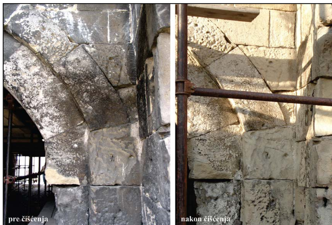
Sl. 8. Izgled dela II fasade pre i nakon čišćenja 2008. godine (Arhiva ZZSKGB)
