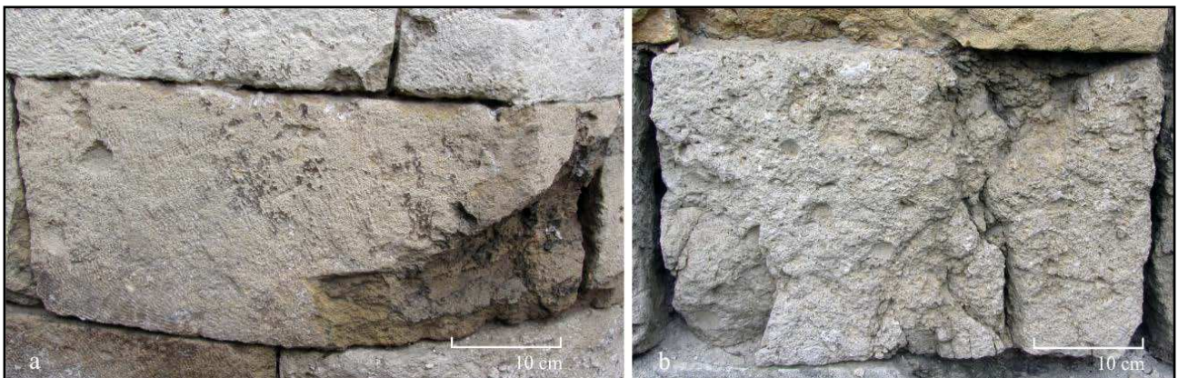
Sl. 56. Komadasto odvajanje kamenih elemenata krečnjaka SZ fasade Mračne kapije: a) nedostatak ugaonog dela bloka grainstone izazvan komadastim fragmentovanjem; b) komadasto raspadanje bloka algalnog rudstone jakog do veoma jakog intenziteta
