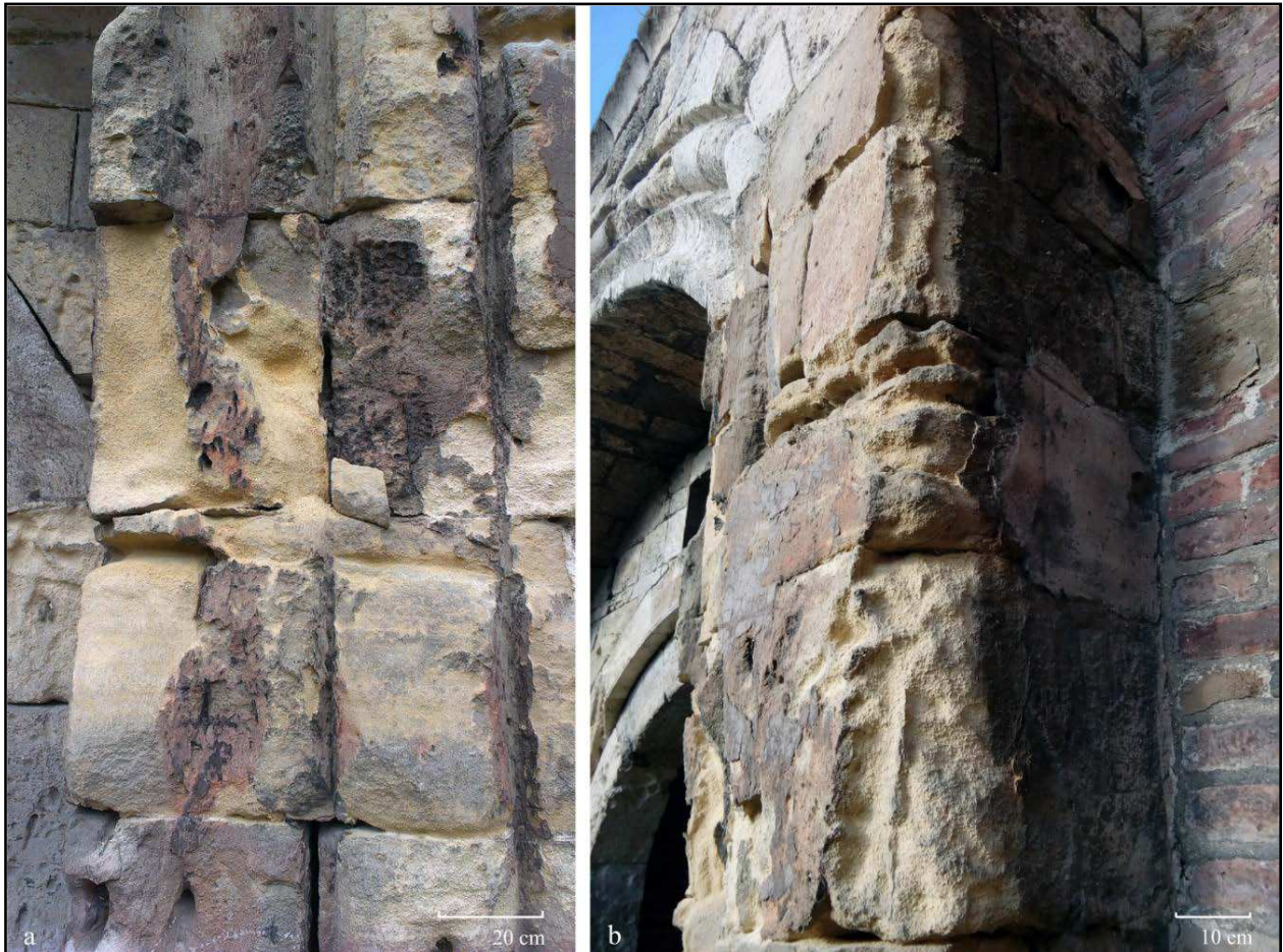
Sl. 62. Narušen integritet blokova profilisanog portala - istočni deo JI fasade; a) intenzivna zrnasta dezintegracija i reljefno raspadanje svih novootvorenih površina grainstone nakon odvajanja kora ili ljuski; b) zrnasta dezintegracija i diferencijalno raspadanje ivičnih blokova grainstone
