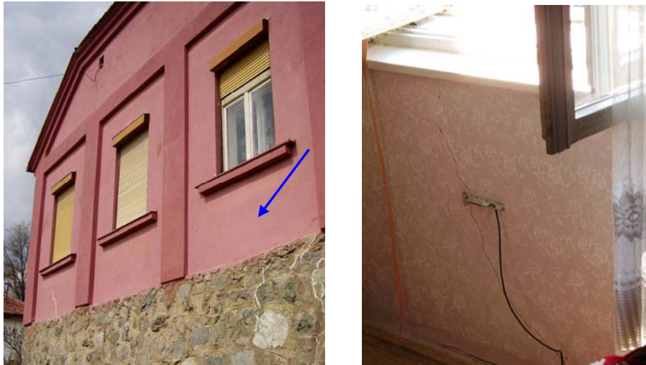
Slika 4-33. Pukotina 1 sa spoljne strane kuće (levo) i položaj senzora na pukotini 1 (desno)[105]
