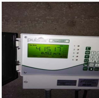
Слика 5.5 – Мерач протока отпадних вода
