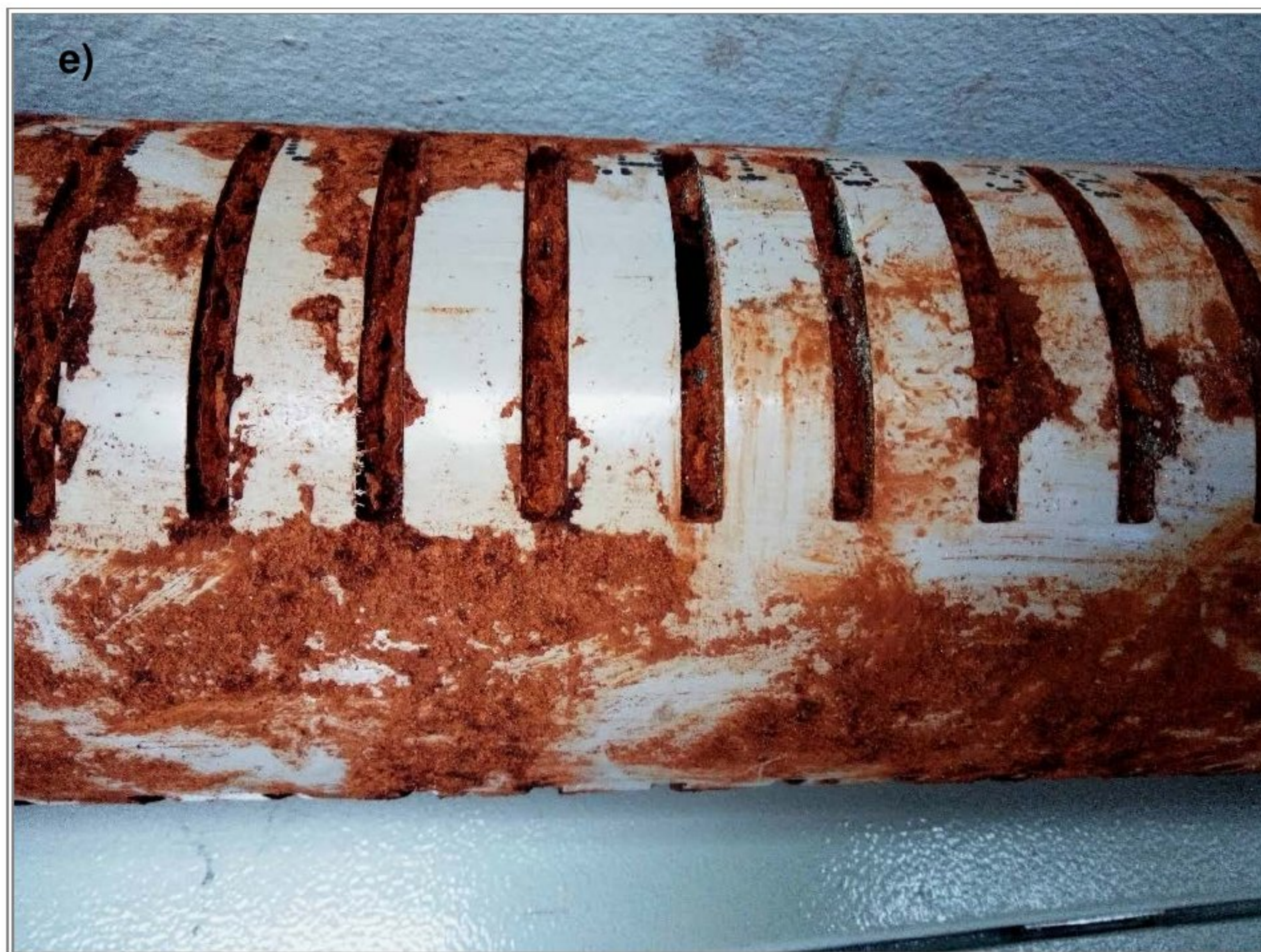
Slika 42: Izgled izvađene PVC filterske cevi; detalj a) i b): debljina kolmiranog sloja u unutrašnjosti cevi; detalj c), d) i e): krupne perforacije na filterskoj cevi intenzivno zapunjene produktima kolmiranja gvoždem
