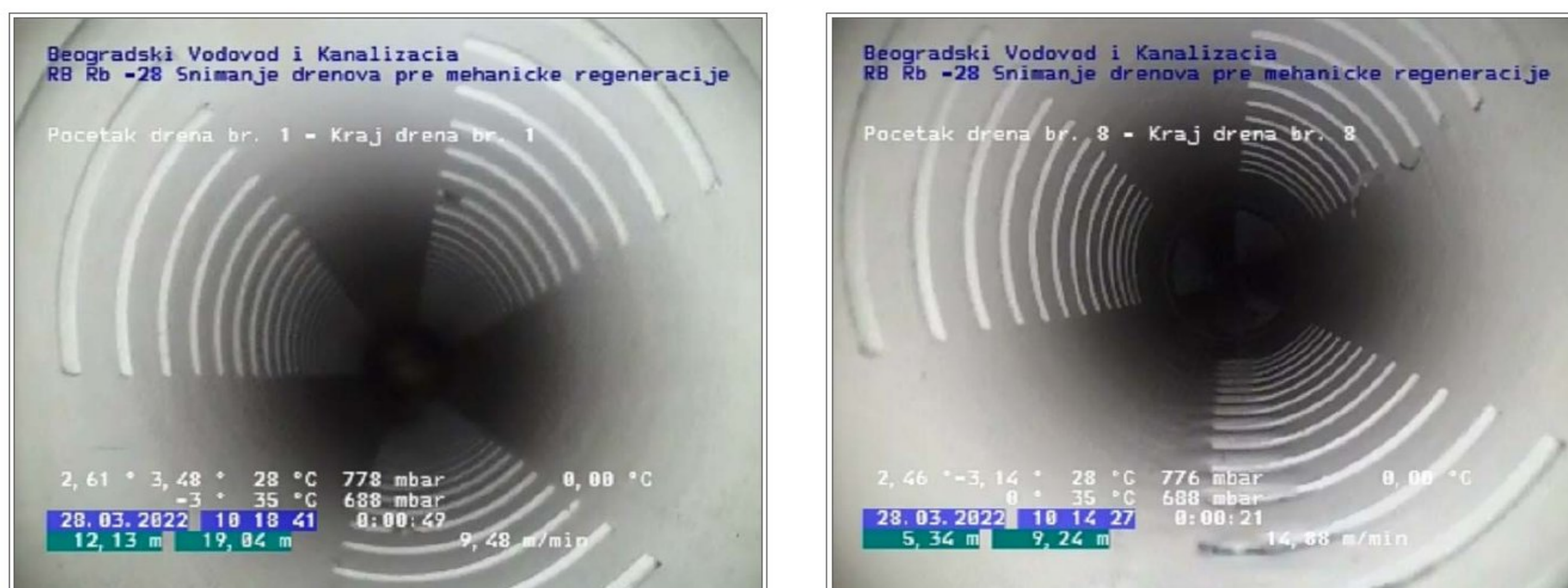
Slika 43: Izgled stanja PVC cevi u drenu 1 i drenu 8 (napomena: oba drena su u potpunosti suva pri slobodnom isticanju u bunarski šaht)
