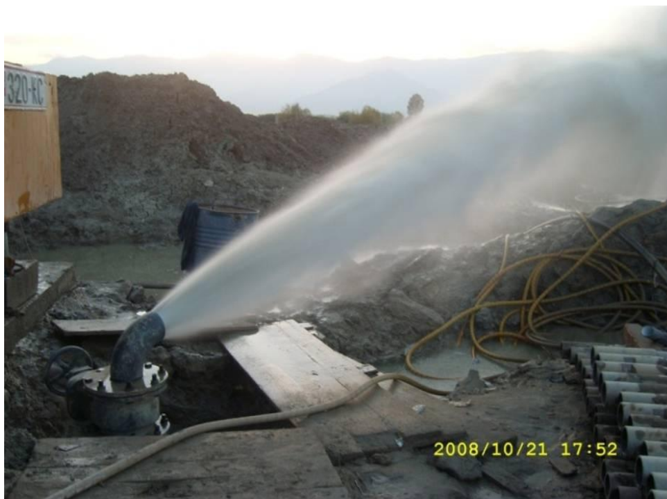
Slika 2.8. Samoizliv mineralne vode praćen erupcijom gasa CO 2 (novouzvedena bušotina B-7a/2008 za potrebe sanacije havarisane bušotine B-7/2008, Foto: D. Petrov)
